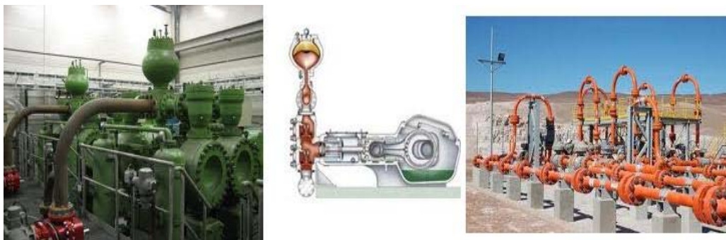
Figura N° 4.12: Concentraducto “minero ducto”- Detalle Bomba Geho 39
